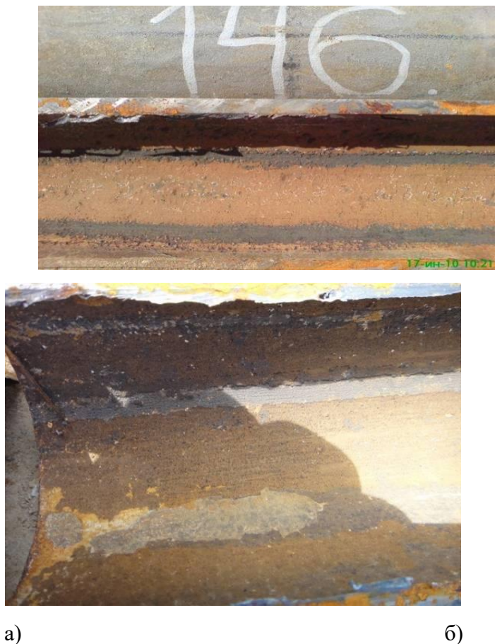
Рис. 4 – Коррозия внутренней поверхности оцинкованных НКТ в виде двух продольных параллельных канавок
