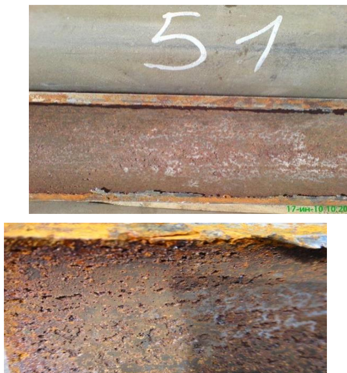
Рис. 3 – Питтинговая коррозия внутренней поверхности оцинкованной НКТ
