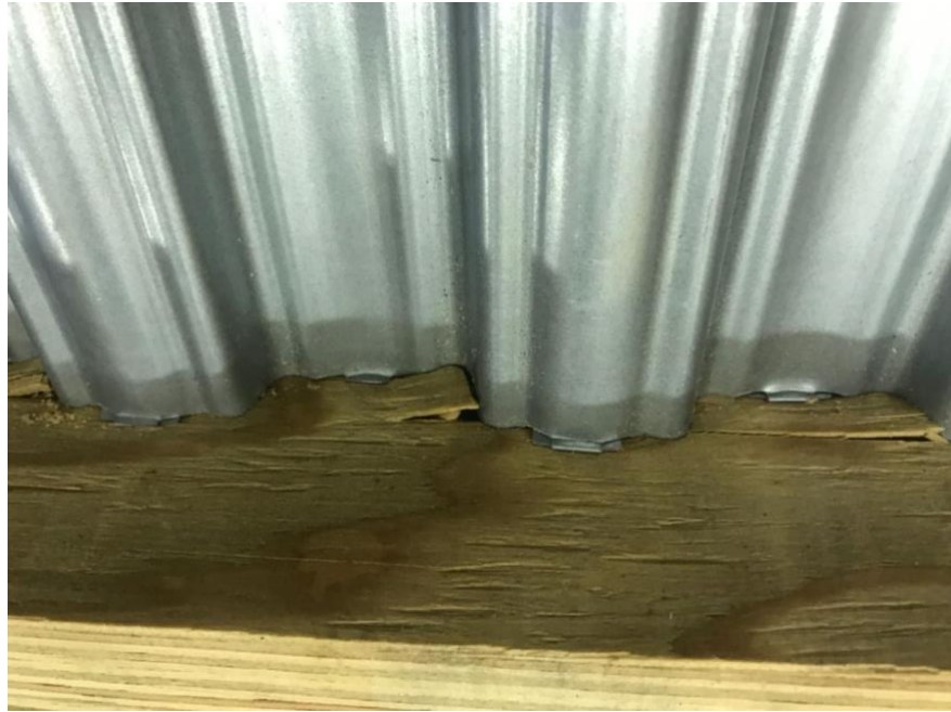
Рис. 2.1.2. Дефекты, образовавшиеся на балке №1 после проведения испытания
